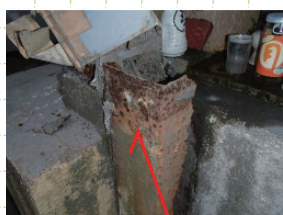
支柱根元腐食
