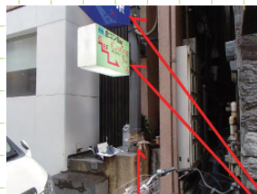
支柱根元腐食
