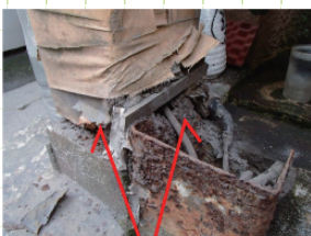
支柱根元腐食
